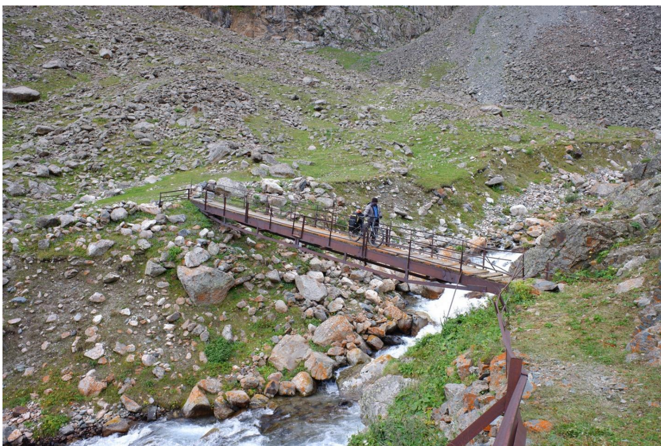
12. Переход на левый берег р. Ашугор по пешеходному железному мосту. Состояние моста удовлетворительное.
